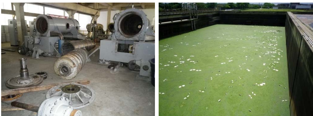
修理待ちの遠心分離施設 （アレグリア処理場）
