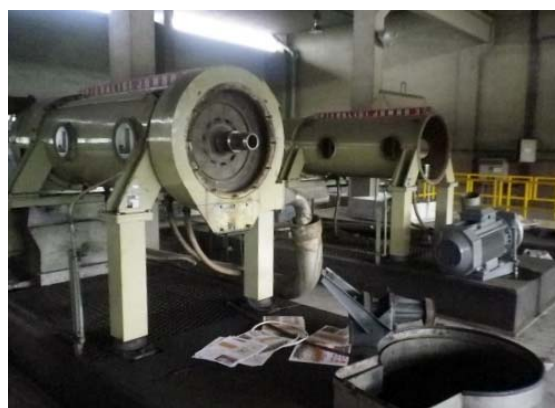
汚泥遠心分離施設 (ペーニャ処理場)
