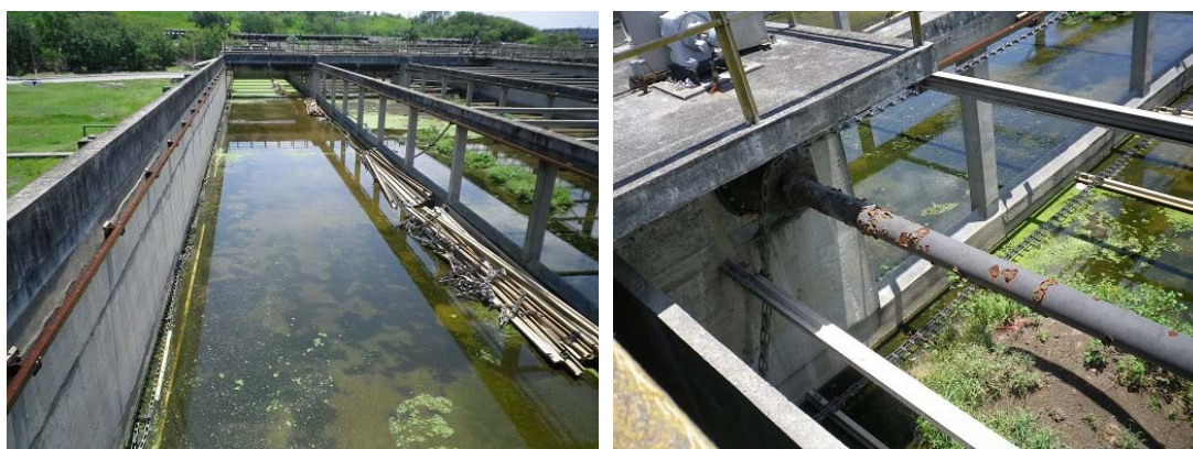
稼働していない一次処理施設（アレグリア処理場）
