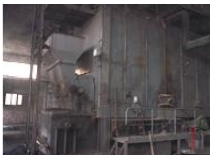
図2 廃止された小型石炭ボイラー
