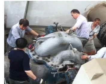
図13 冷却水循環ポンプ点検
