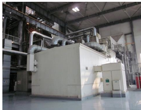
ガスタービン（防音用建屋内に格納）
