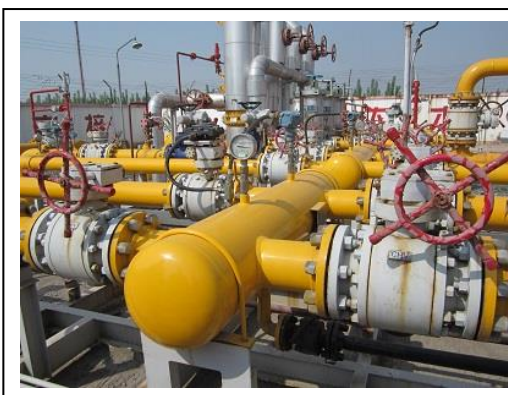
図 17 ゲートステーション内配管（焦作）
