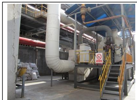
図 15 大口ユーザー設備（焦作市）
