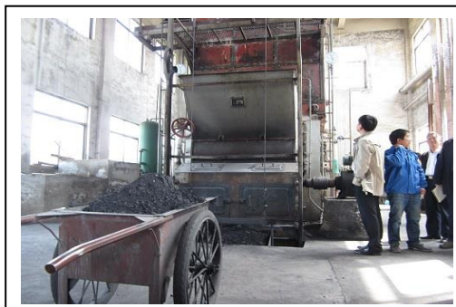
図 5 石炭ボイラー設備（滁州市内）
