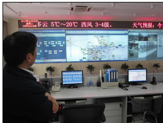
SCADA システム（合肥市）
