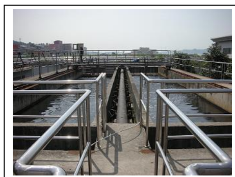
臨江溪下水処理場の沈殿池
