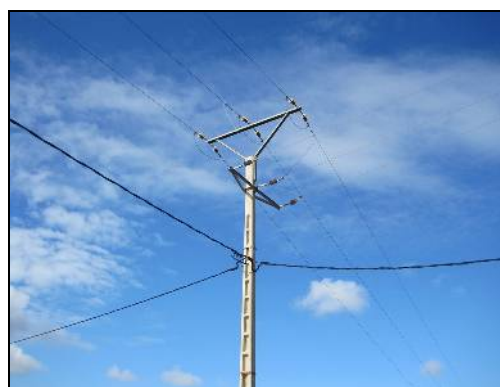
整備された配電網（エッサウィラ県）
