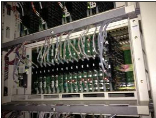
交換機 空きスロットが目立つ
