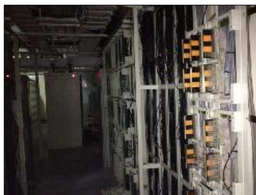
交換機施設（ハラレ市内）
