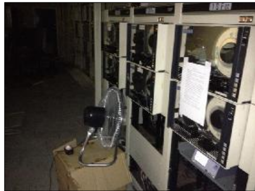
冷却装置がないため扇風機を代用している
