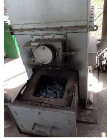
Siem Reap 州病院に設置された焼却炉
