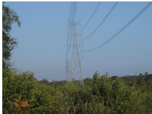
整備された送電線
