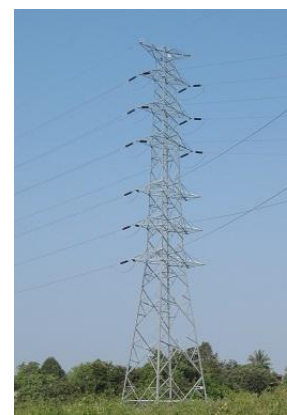
写真2 4回線鉄塔 (パクサン変電所近辺)
