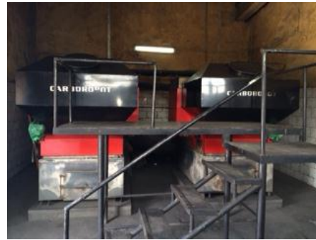
購入したボイラー
