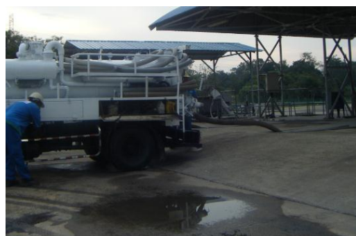
スンガイウダン汚泥処理場
