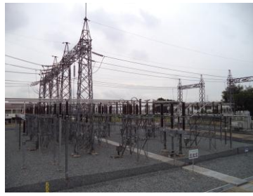
ロジャナ 2 変電所
