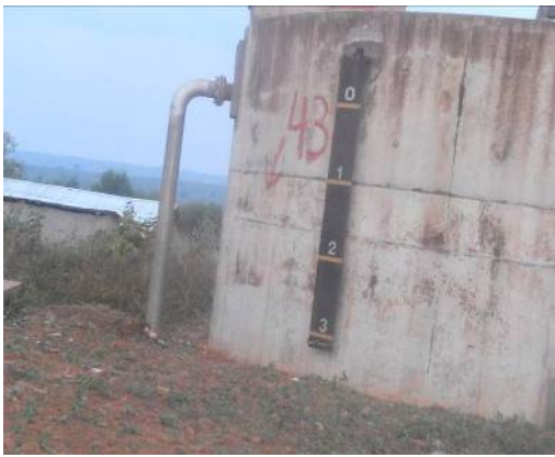
ルワマガナ郡にある満水状態の水タンク
