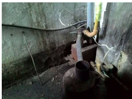
写真1：イシククリ州チョン・クズルス村一のパイロットプラント4号機の操作室内。壁に線がみられるように、昨冬、室内に水が入り凍結した結果、加温装置やパイプなどの設備が損傷した。
