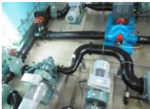
ポンプ室、送水ポンプ配管
