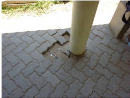
写真 12 通路の陥没したブロック (マプト州コベ校)
