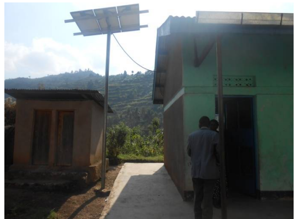
冷凍庫用電源の太陽光パネル
