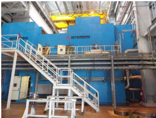
ガスタービンが入っている施設
