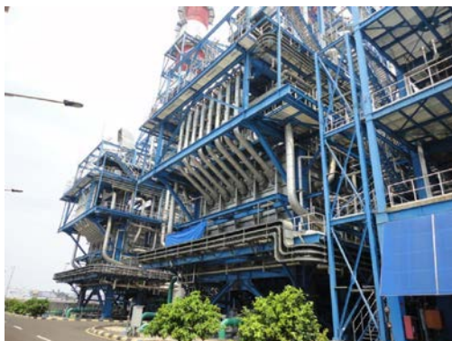
排熱回収ボイラー
