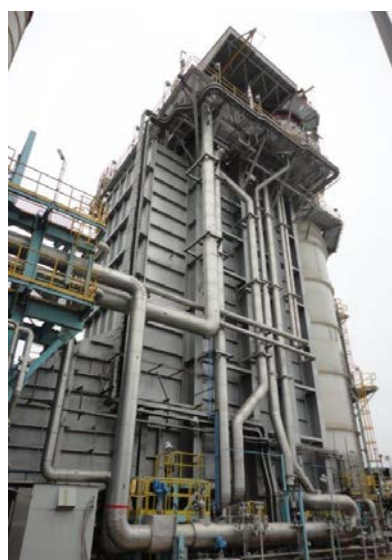
排熱回収ボイラー
