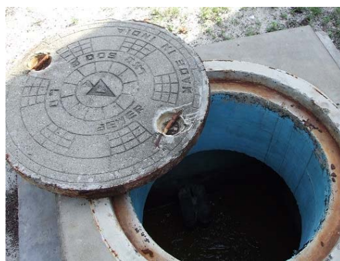
下水道ポンプ場 Eydhafushi
