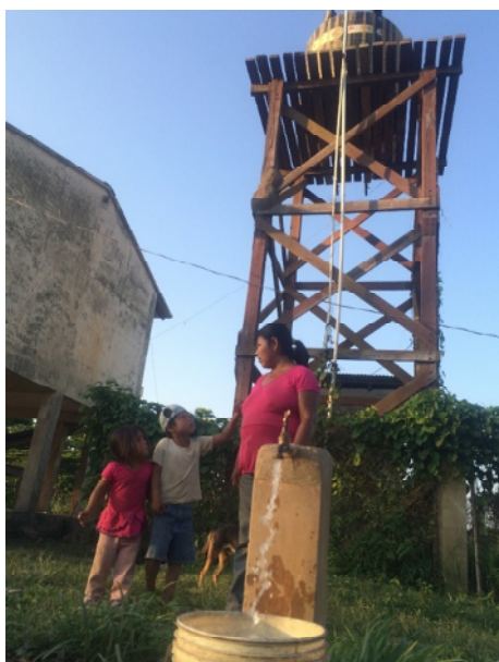
(ベニ県のプエルト・ヘラルダ村落の太陽光パネルを供えた給水施設)
