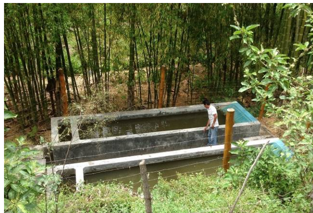
パイロット事業で改善された浄水施設 (ランバイエケ州エスピナル村)
