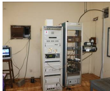
番組入力機器ラック
