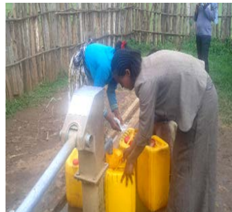
ポンプ式井戸給水施設 ウエストショワ県 ジェルドウ郡
