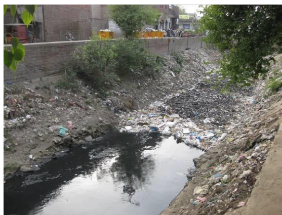
シャドバーポンプ場につながる開放型排水路
