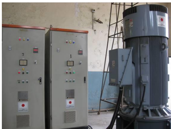
ポンプモーターと操作パネル (マルチロードポンプ場)
