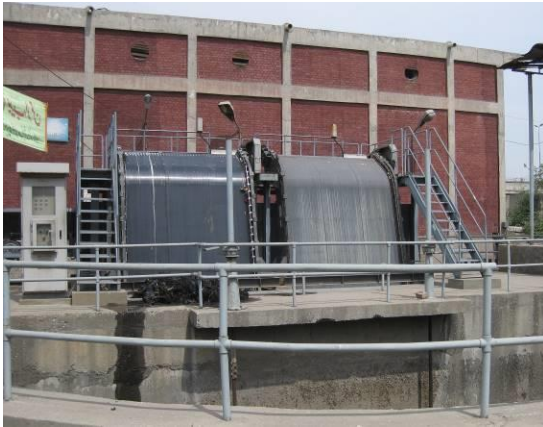
自動除塵機（シャドバーポンプ場）
