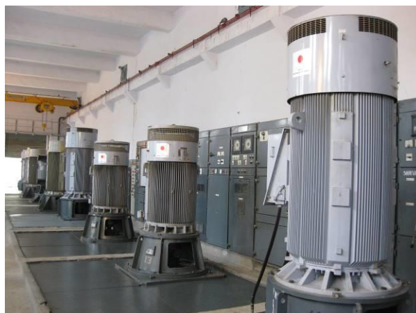
ポンプ場操作室・電気室 (グルジャンイーラビポンプ場)
