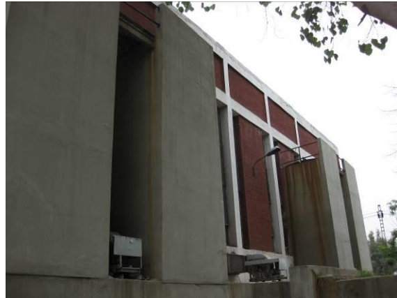
吐出水槽（ムルタンロードポンプ場）
