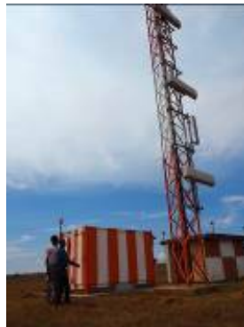
計器着陸装置 (グライドパス)
