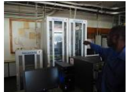
コントロールルーム
