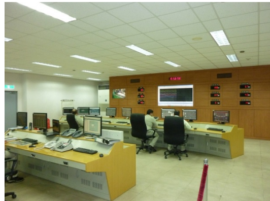
写真 2：同施設内の中央制御室
