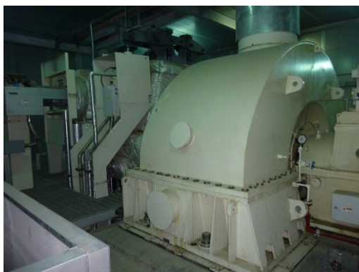
写真 3：ガスタービン発電設備
