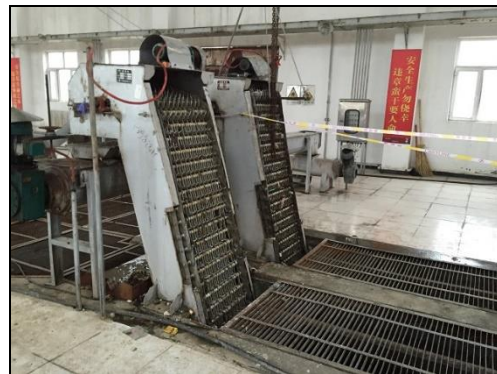
汚水処理場 粗目スクリーン
