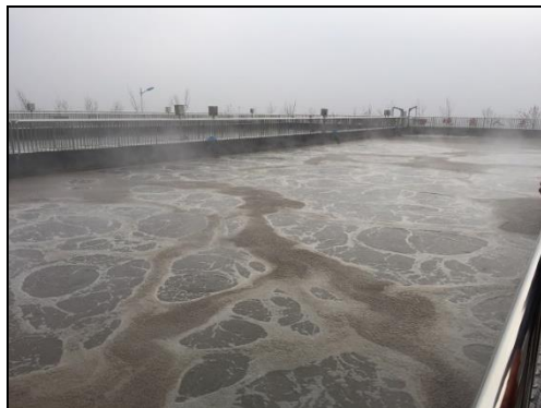
汚水処理場 生物反応池
