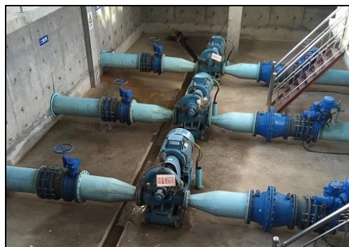
上水道整備事業で整備された浄水ポンプ
