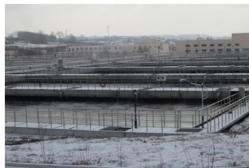
平房下水処理場の反応槽
