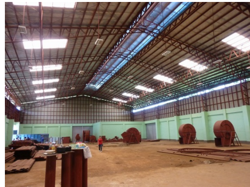
写真2：とうもろこし乾燥処理施設の内部の様子
