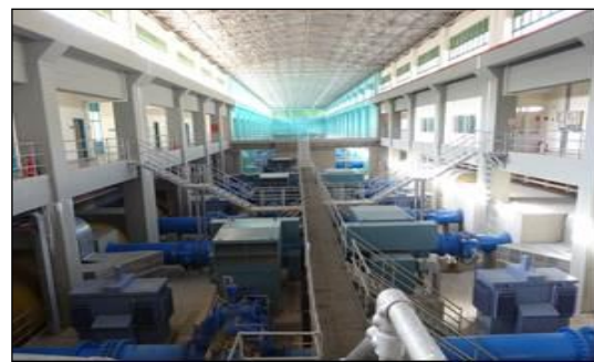
本事業で整備したメレンポンプ場
