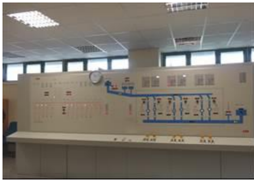
浄水場内コントロールルーム
