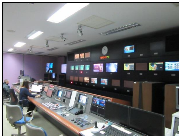
本事業で整備したコントロールルーム
