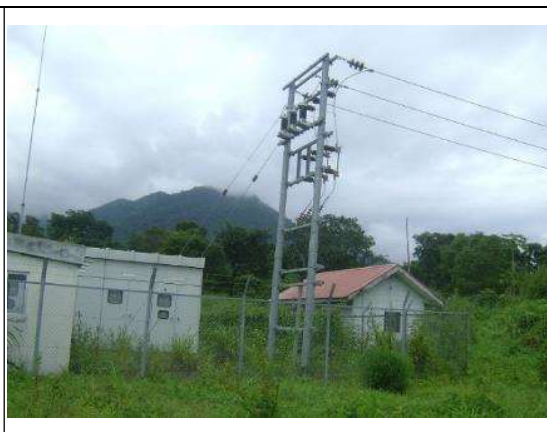
ブースターステーション及び配電線
