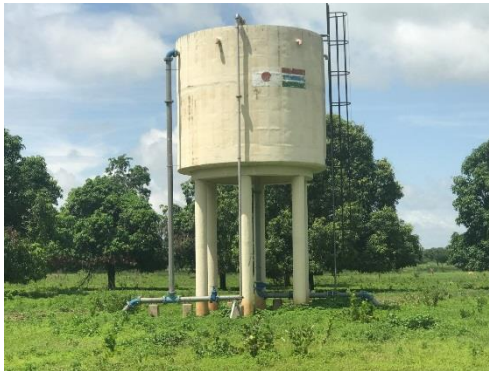
給水施設のタンク
