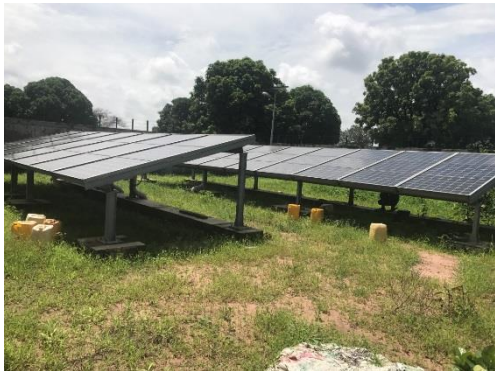
給水施設のソーラーパネル
