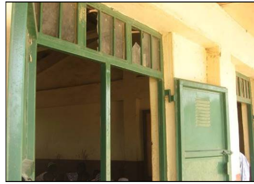
破損したままの窓ガラス (Tumfafi 小学校)
