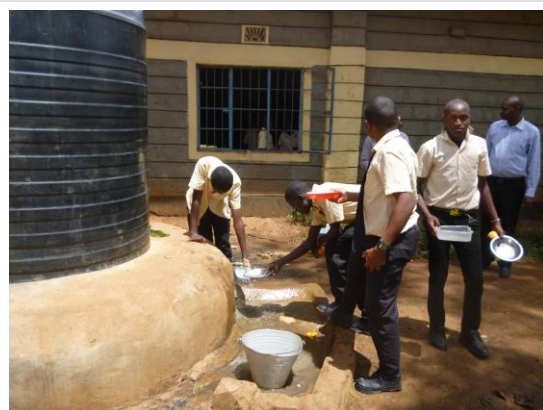
マチャコス郡ムワラ県ミウ中学校内の給水施設
