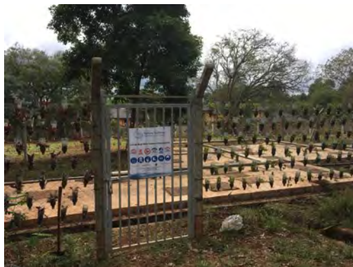
敷地内の排水処理・リサイクル施設 塩素以外の薬品を使わず処理し、環境管理局の排水水質基準を満たす。柵とペットボトル再利用の植木ポットは、見学者への意識啓発のために事業後に設置。ケニア水道研修所で研修を受けていたインドからの研修員が訪問したこともある。
