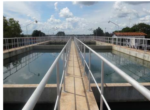
コンセプション浄水場：薬品沈殿池
