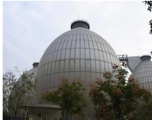
袁楽村下水処理場の汚泥消化槽
