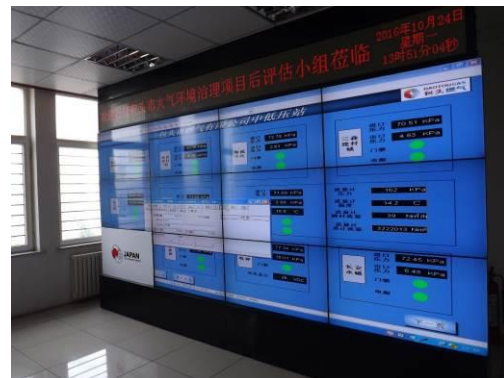
SCADA システム (ガス会社本部に設置)
