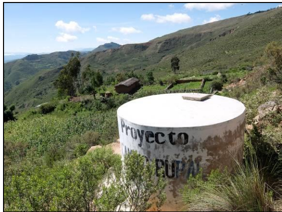
設置された小規模灌漑用タンク (プレスト村ミッシェンパンパ集落)
