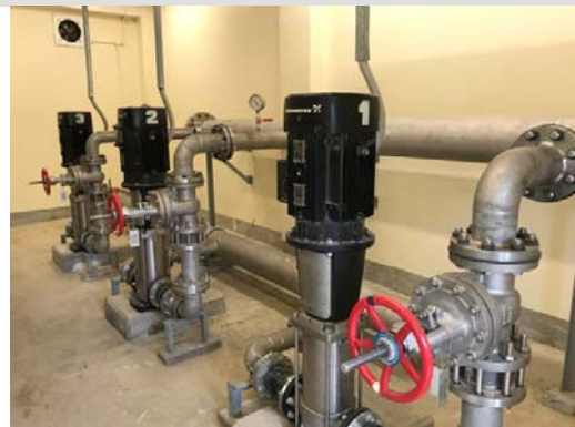
本事業で設置された送水ポンプ
