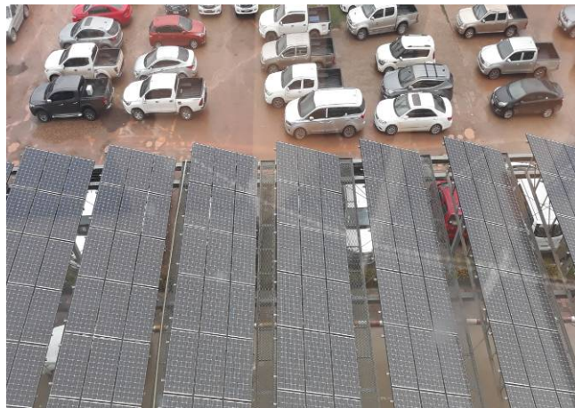
太陽光発電システム
