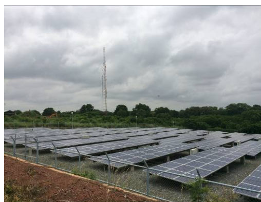
400kWp システム（追加分）
