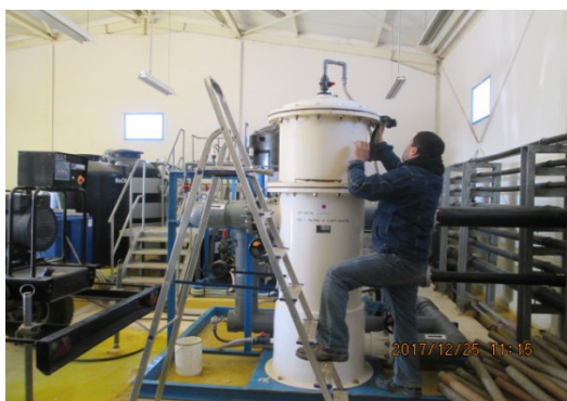
写真1：淡水化プラント施設内
