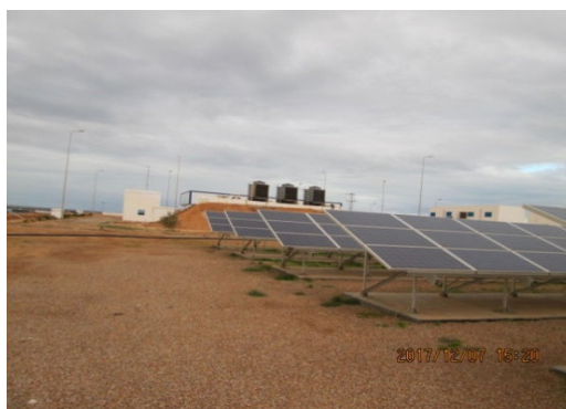
写真2：太陽光発電システム
