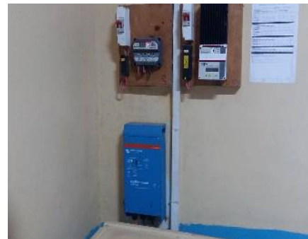
サンプルカウンティ、サウスホール保健施設の良く維持管理された太陽光発電システム
