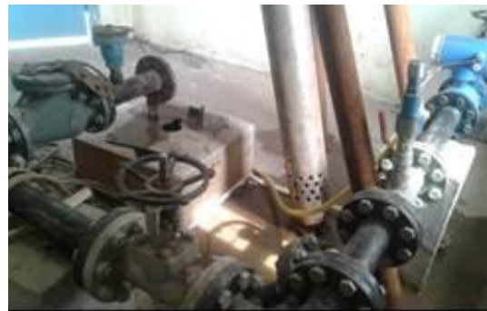
写真 4. 故障のため使用されていない新設井戸の取水設備 (ドバートル No.3)
