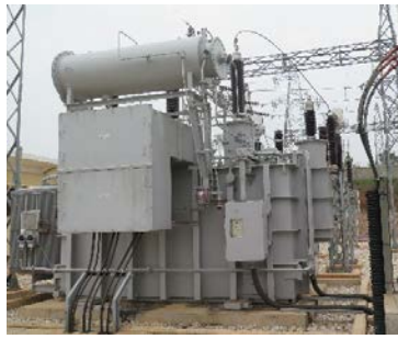
ムシャ変電所主変圧器
