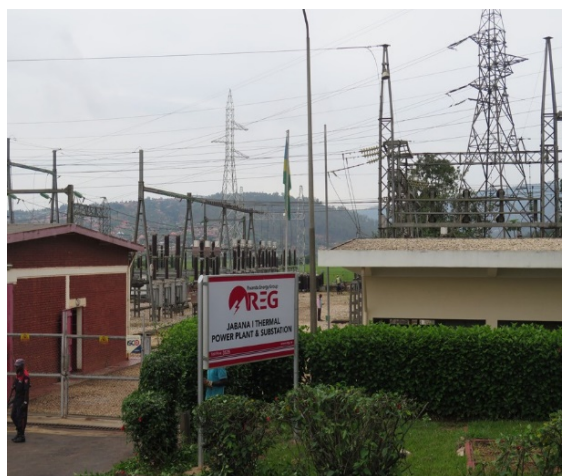
本事業で改修したジャバナ変電所
