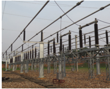
ギコンド変電所屋外開閉器
