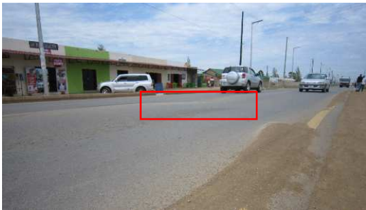
写真：道路不陸箇所の一つ (赤枠で囲った部分が沈んでいる)
