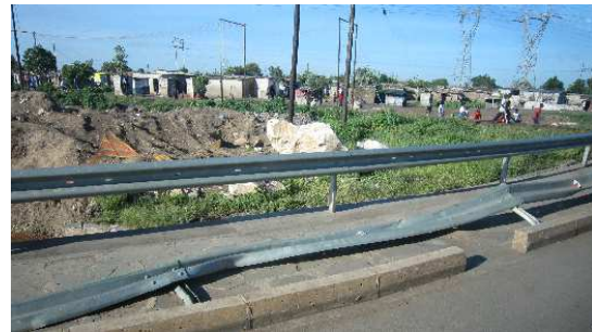
写真：壊れたガードレール
