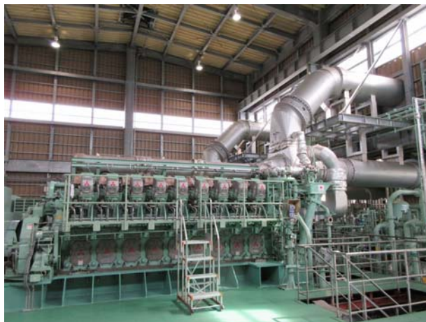
本事業で設置した発電機
